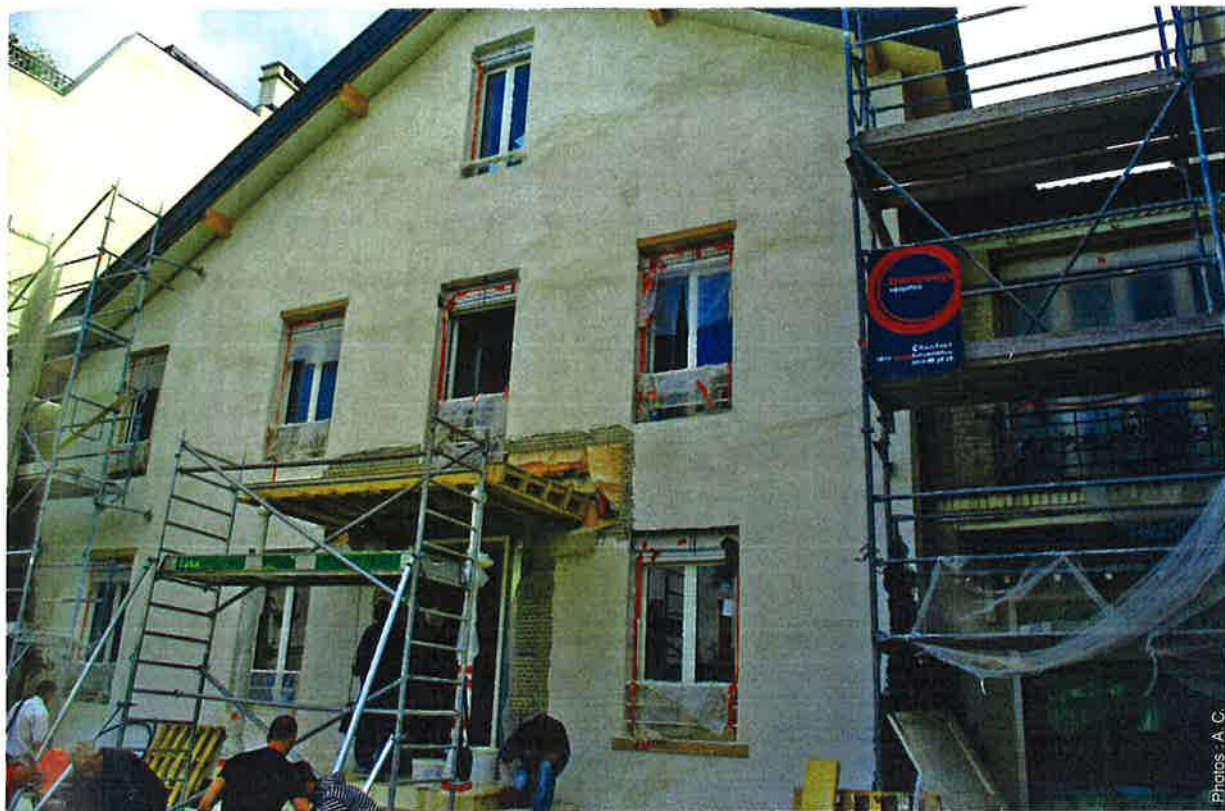
— Les façades sont isolées par l'extérieur sans bouleverser l'aspect de la maison.
